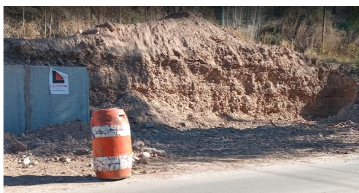
Figura N°2 – Ubicación donde desaguaría el agua. Intersección Calle Darragueira y Malvinas
